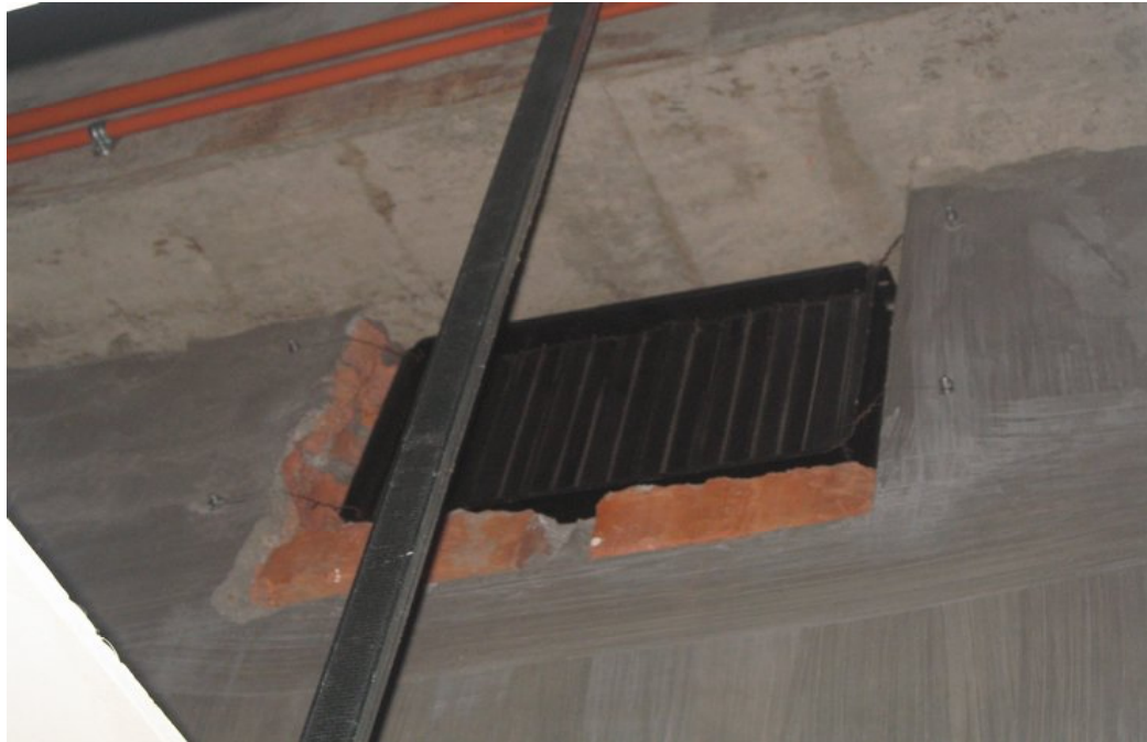
Gambar 7: Terdapat bukaan fresh air grill dalam ruangan siling di Bilik Perbincangan 4 Aras 5
