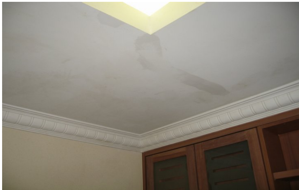
Gambar 4: Kulat pada siling di Bilik Perbincangan 4 Aras 5
