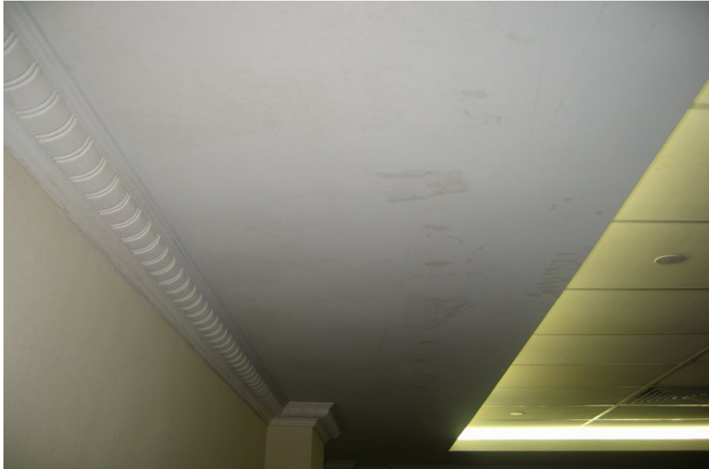
Gambar 5: Kulat pada siling di Bilik Perbincangan 10 Aras 6
