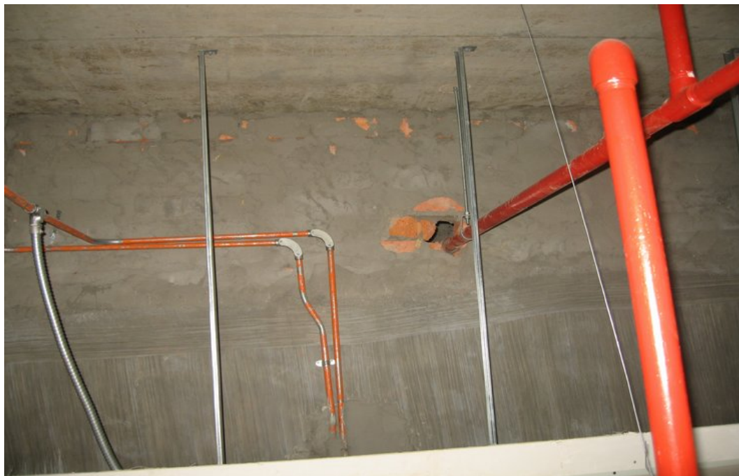
Gambar 8: Bukaan lubang lubang pada paip sprinkler dalam ruangan siling di Bilik Perbincangan 4 Aras 5
