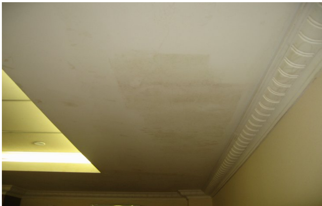
Gambar 6: Kulat pada siling di Bilik Perbincangan 11 Aras 7
