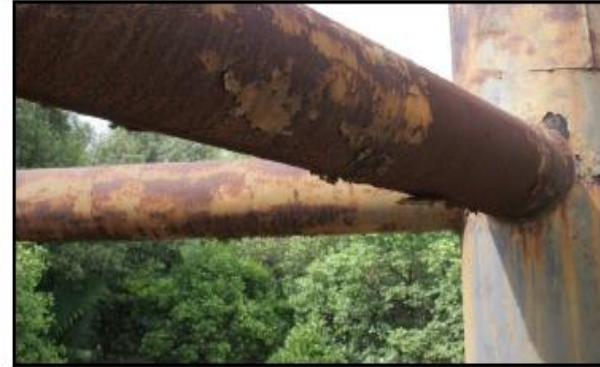
Foto A-1 : Kesan pengaratan pada steel guide pile di kawasan pontoon/jeti
