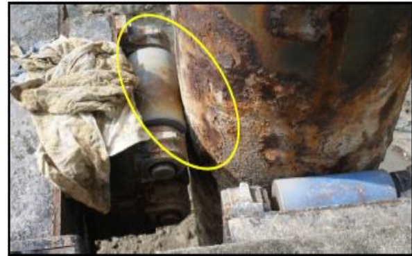
Foto A-2 : Kesan pengaratan pada roller guide pile di kawasan pontoon/jeti
