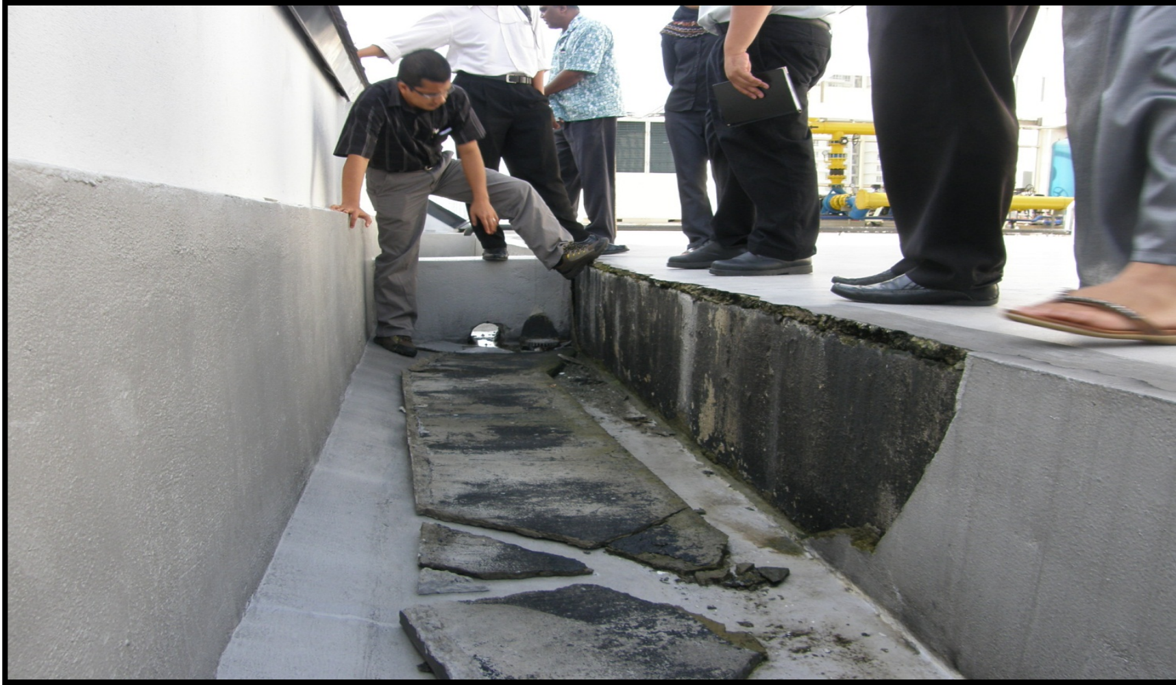
Lepaan pada dinding gutter tertanggal
