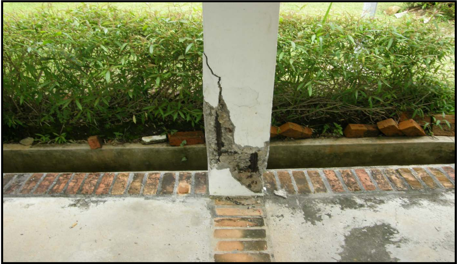
Tiang retak dan konkrit tertanggal. Besi tetulang mereput
