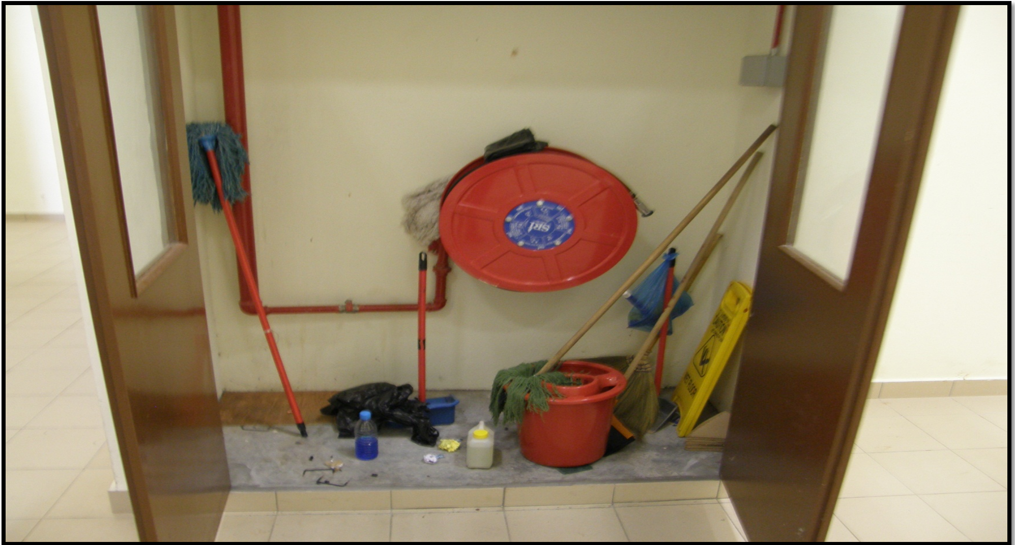
Bilik hosereel dijadikan tempat simpanan barang
