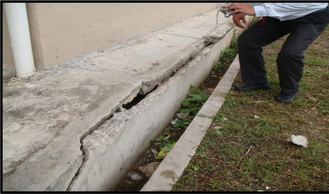
Keretakan yang serius akibat mendapan di kaki lima
