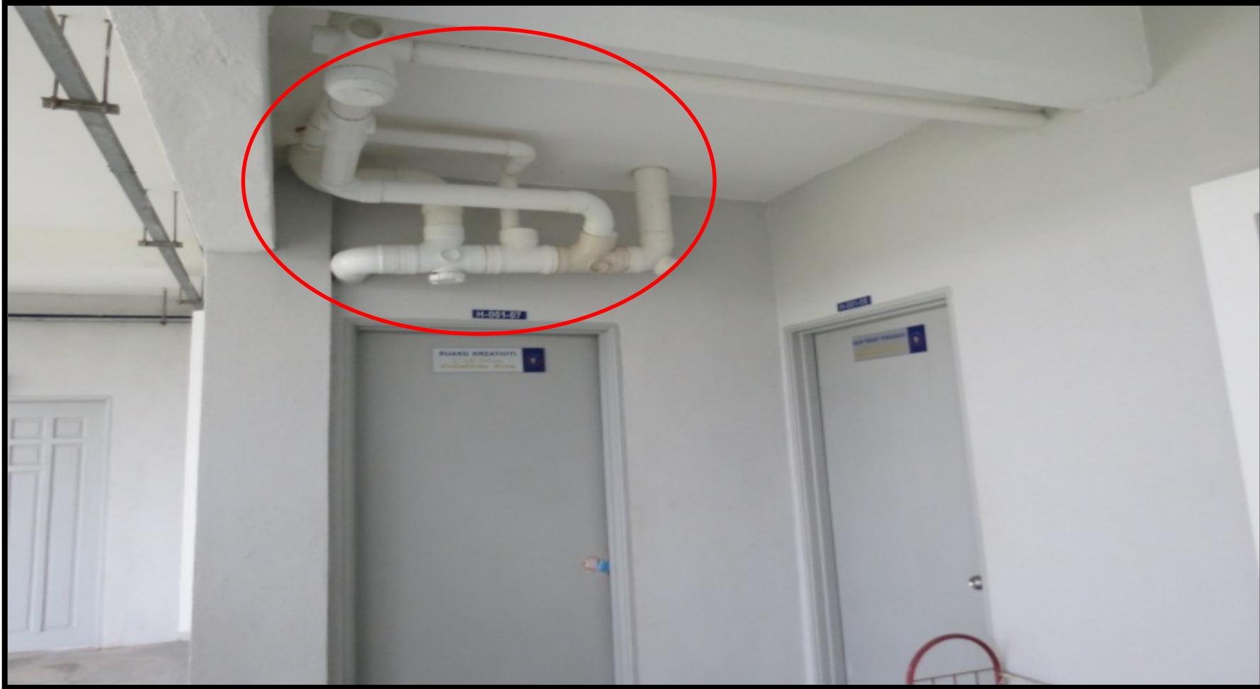
Saluran paip sanitari berada di atas pintu dan tidak ditutup ( box up )
