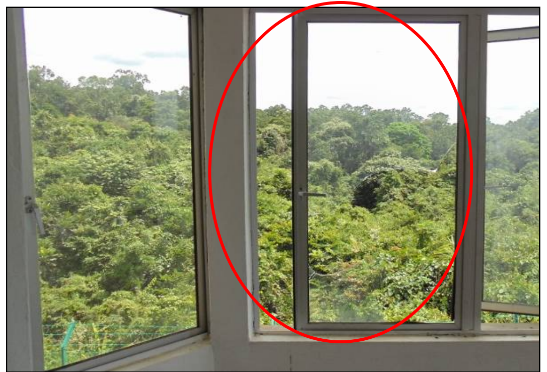
Kesilapan pemasangan tingkap
