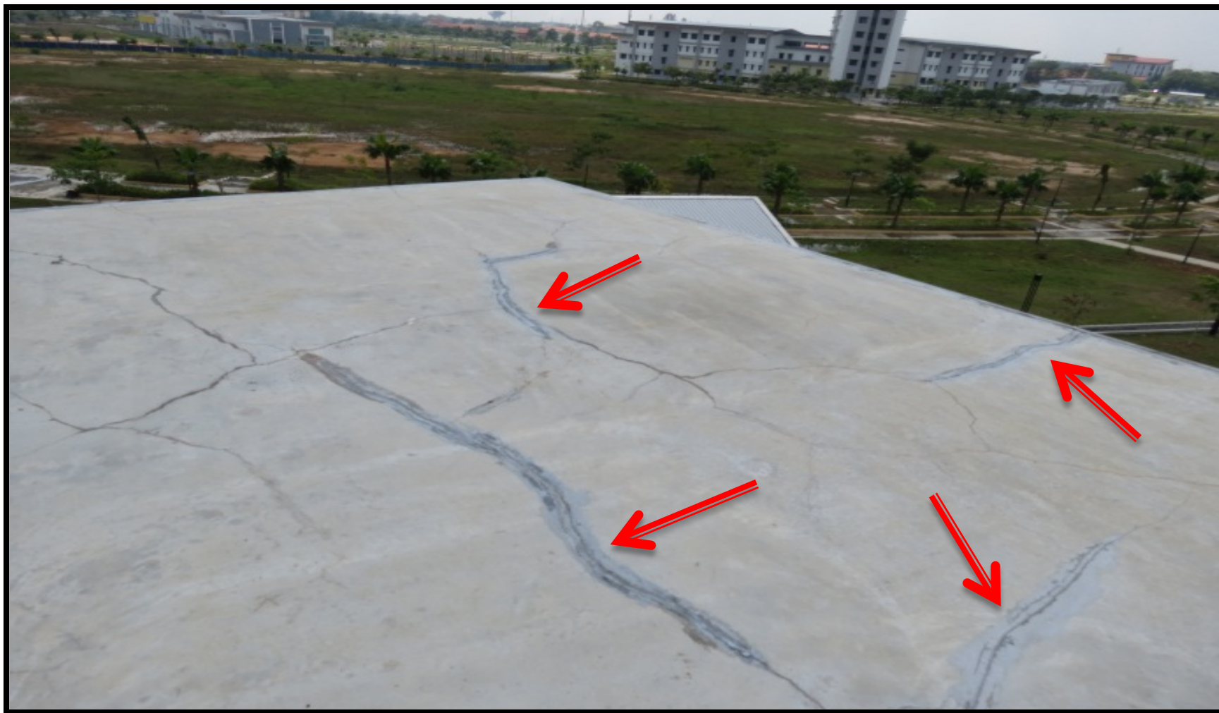
Keretakan di permukaan lantai bumbung rata
