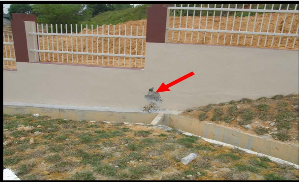
Permukaan tiang pagar dipecahkan untuk laluan pendawaian elektrik. Tiada koordinasi di antara kontraktor sivil dan elektrik
