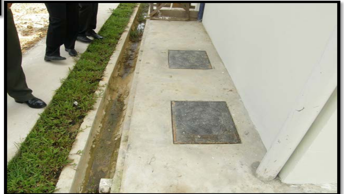
Kedudukan lurang tidak sesuai di apron bangunan
