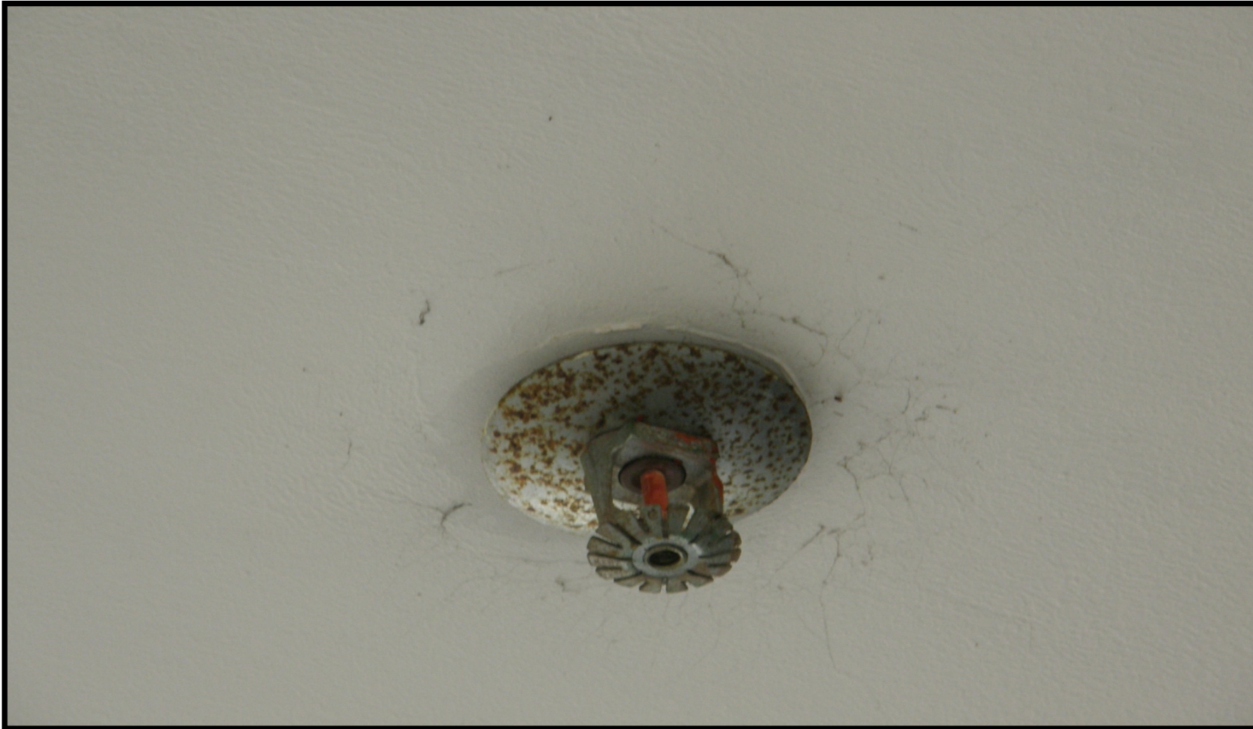
Sprinkler telah berkarat
