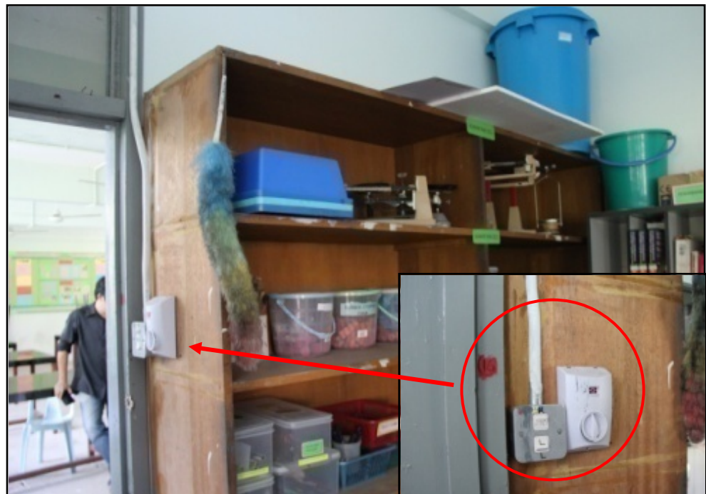
Suis di Makmal Sains sepatutnya dilekapkan ke dinding tetapi dipasang pada almari
