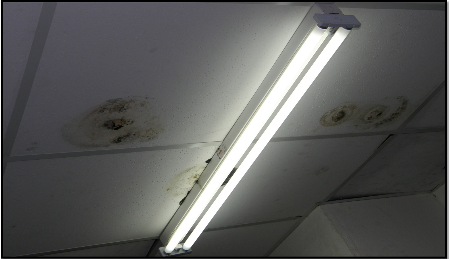
Kebocoran berdekatan dengan lampu
