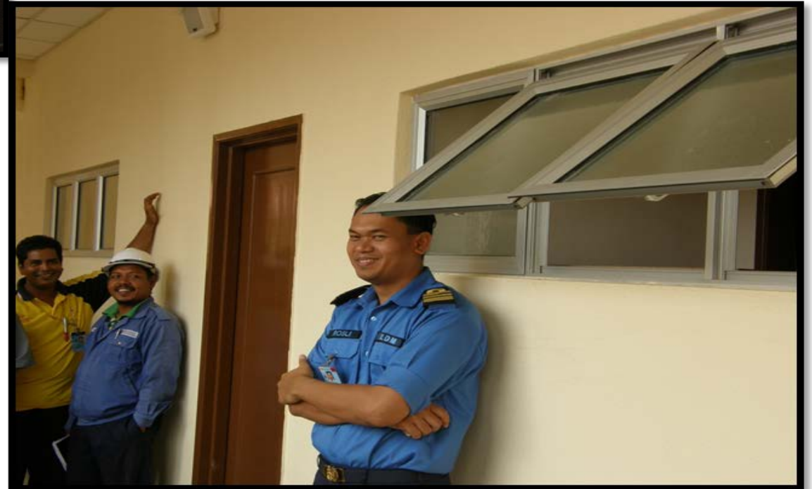
Tingkap jenis top hung tidak sesuai di koridor
