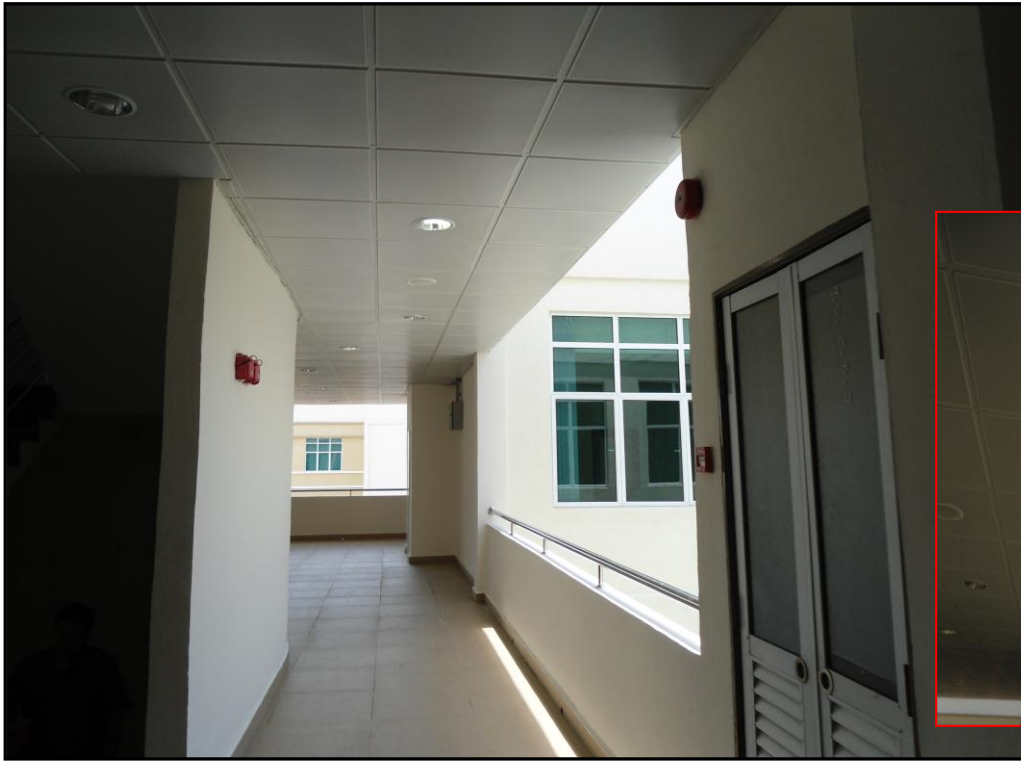
Gambar 9.7 : Korridor (Tempias air hujan)
