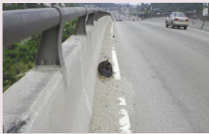
Lubang salur air (weep holes) yang tidak disenggara dengan sempurna/tersumbat.
