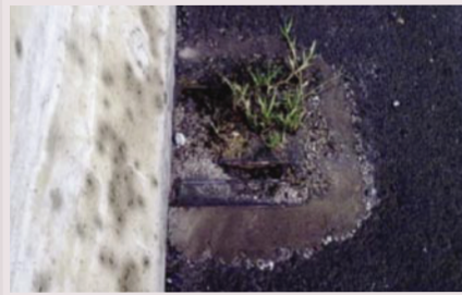
Lubang salur air (weep holes) yang tersumbat akibat tumbuhan liar.
