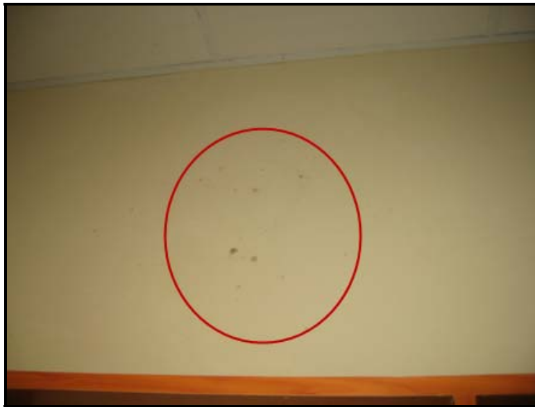
Gambar 5: Menunjukkan pembentukan kulat pada permukaan dinding di Bilik Rekod
