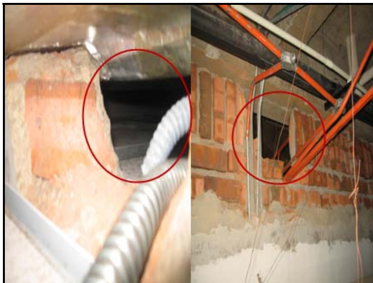
Gambar 2: Menunjukkan dinding yang dipecahkan tidak ditutup dengan sempurna.
