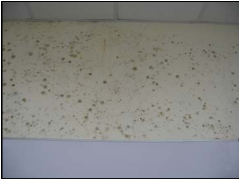
Gambar 1: Menunjukkan permukaan dinding yang berkulat
