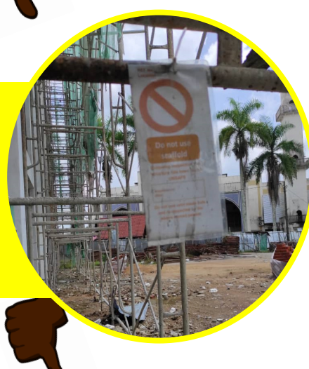
Pemasangan Red Tag Yang Jelas
