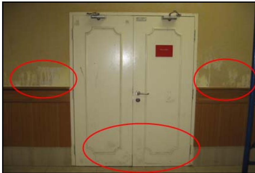
Gambar 4: Pembentukan kulat pada permukaan pintu dan kesan kondensasi pada permukaan dinding di bilik MDF dan bilik PABX
