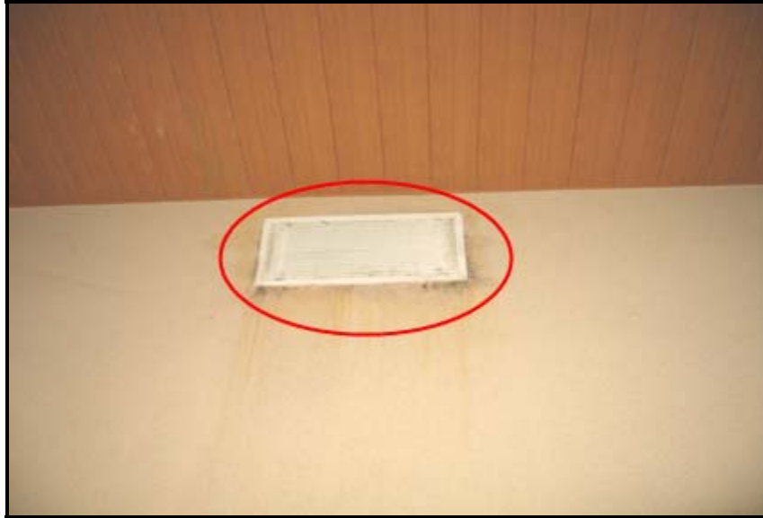
Gambar 5: Berlaku pembentukan kulat sekitar diffuser di laluan lift aras 1.
