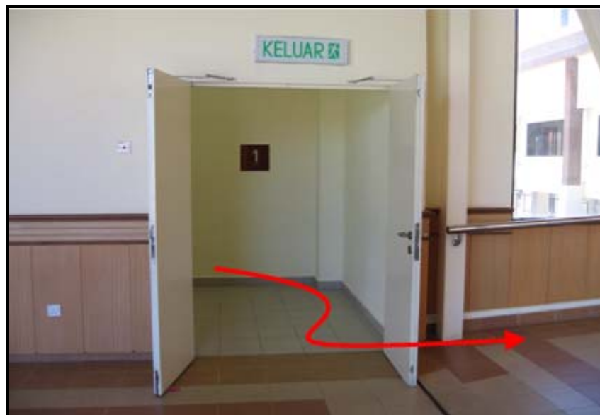
Gambar 8: Pintu yang sentiasa terbuka menyumbang pada berlakunya kondensasi pada permukaan diffuser di laluan pertukaran( transfer corridor ) balai ketibaan domestik aras 1.
