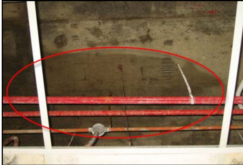
Gambar 1: Concrete slab lembap (disebabkan kondensasi) terjadi di bilik rehat, aras bawah Jabatan Penerbangan Awam.
