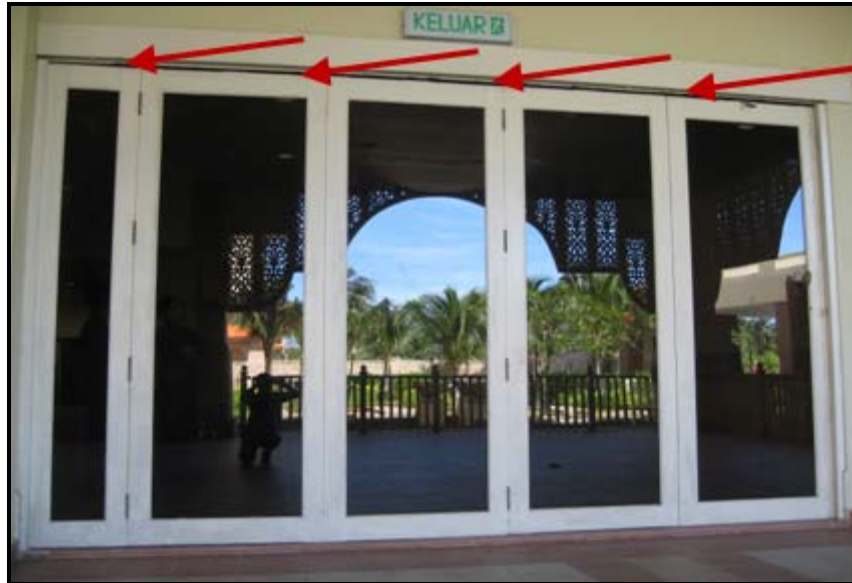
Gambar 3: Berlaku kemasukan udara luar ke bahagian dalam bangunan melalui ruang ( gap ) antara pintu berdekatan lokasi lot kedai aras bawah.
