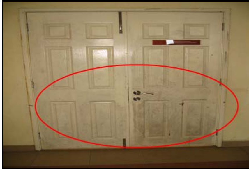
Gambar 11: Terdapat pembentukan kulat pada permukaan pintu di bilik pemeriksaan keselamatan.
