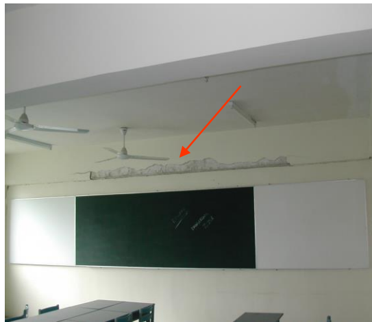
Keretakan lepaan pada tengah rasok di Tingkat Satu
