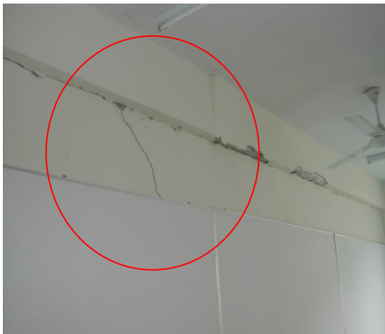
Keretakan Dinding di Tingkat Satu
