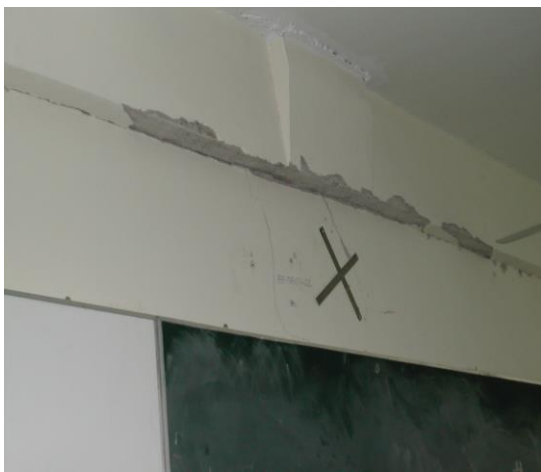
Keretakan Dinding bangunan di Tingkat Dua
