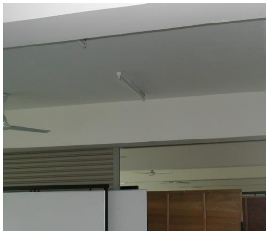
Tiada Keretakan pada struktur lain di Tingkat Dua
