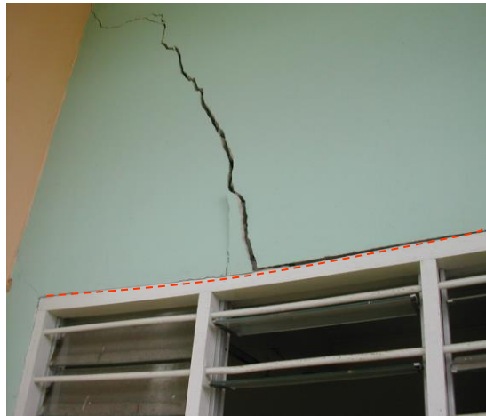
Keretakan Dinding bata diatas bingkai tingkap di Bangunan Kantin (Berlaku Lenturan)
