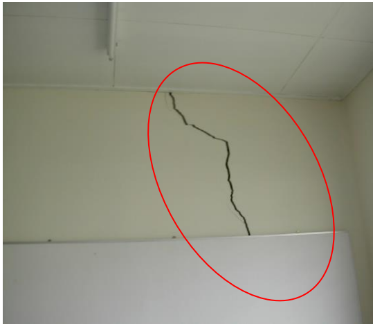
Keretakan Dinding (Bahagian tepi bangunan) pada tingkat 3
