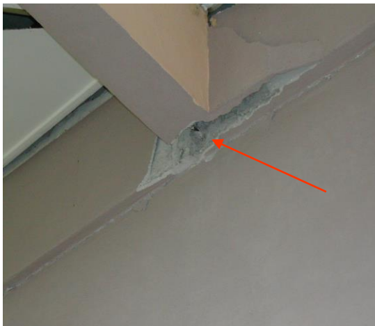
Keretakan pada sambongan diantara Struktur Tangga dengan Bangunan Sekolah
