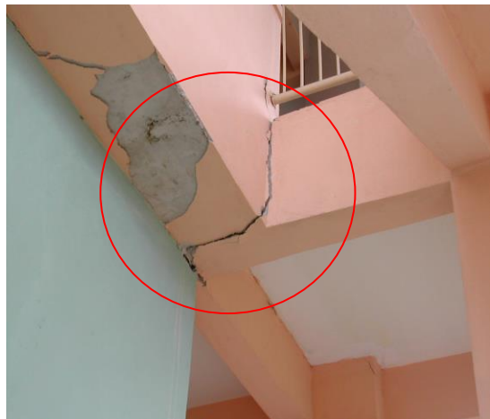
Keretakan pada sambongan di antara Struktur Tangga dengan Bangunan Sekolah Tingkat 1
