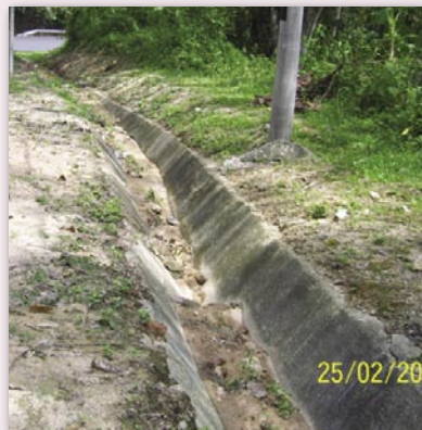
Longkang konkrit tuang di situ jenis V.
