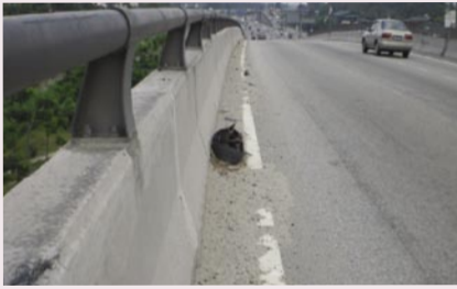
Gambarfoto : Lubang salur air (weep holes) yang tidak disenggara dengan sempurna/tersumbat.
