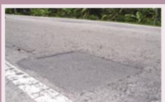
Pemadatan tidak mencukupi menyebabkan tampalan tidak searas dengan permukaan pavemen sedia ada.
