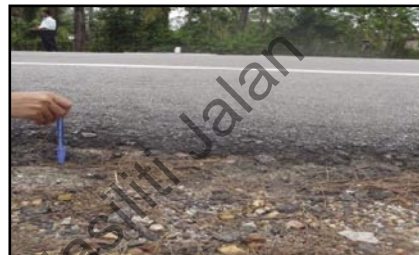
GAMBAR 2 : PERBEZAAN ARAS ANTARA BAHU JALAN DAN PERMUKAAN JALAN > 25mm
