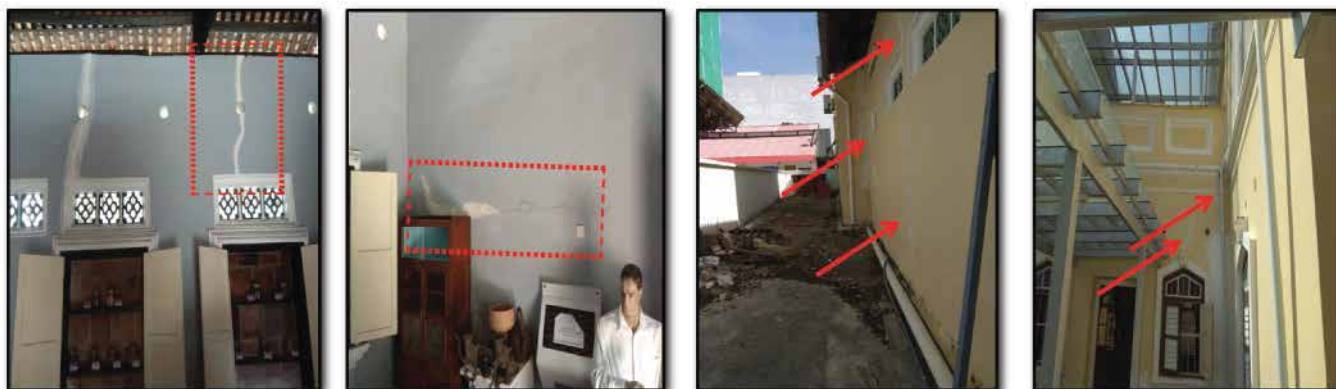
Keretakan-keretakan dinding bahagian bangunan.
