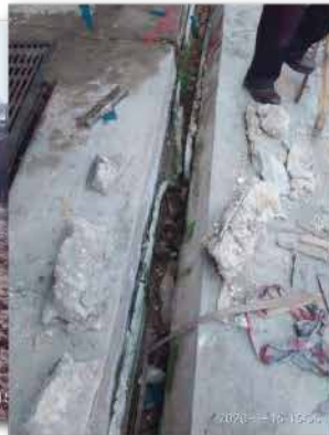
Stuktur bersebelahan yang mengalami keretakan
