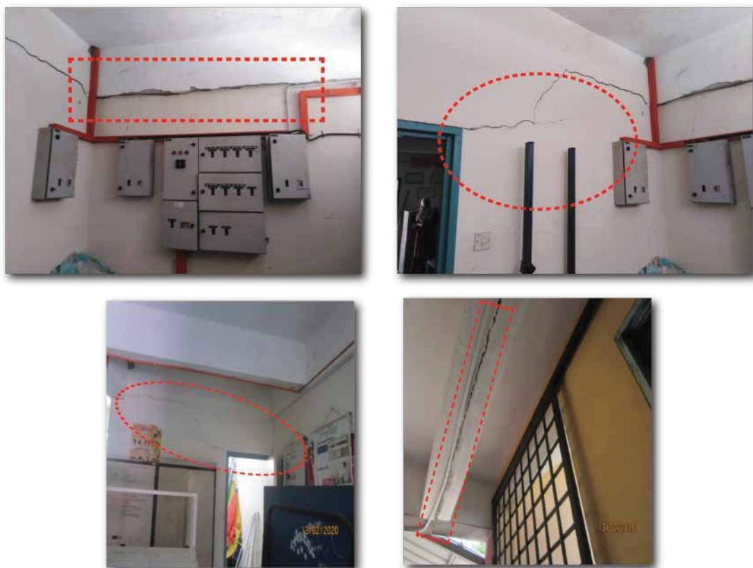
Keretakan tembus pada struktur dinding di dalam bilik Pendidikan Jasmani dan Kesihatan Blok D (berhadapan dengan tangga).
