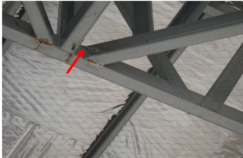
Gambar 5 : Sambungan kimpalan yang tidak sempurna pada sambungan kekuda bumbung
