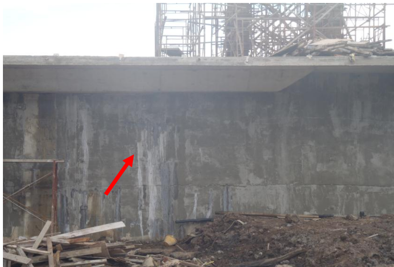
Gambar 4 : Kebocoran air pada dinding kolam renang
