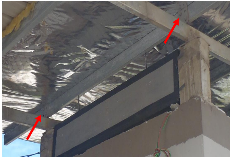
Gambar 1 : Pemasangan sambungan bolt pada kekuda bumbung tidak sempurna.
