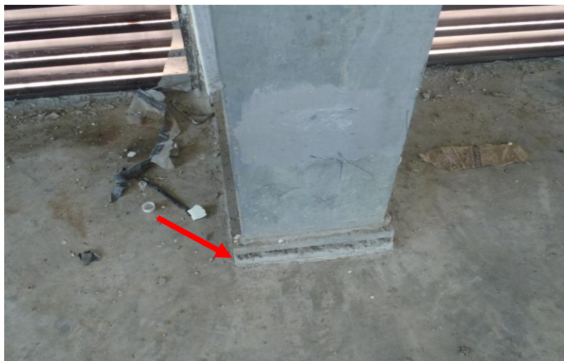
Gambar 6 : Ruang kosong di antara concrete base dengan steel base plate
