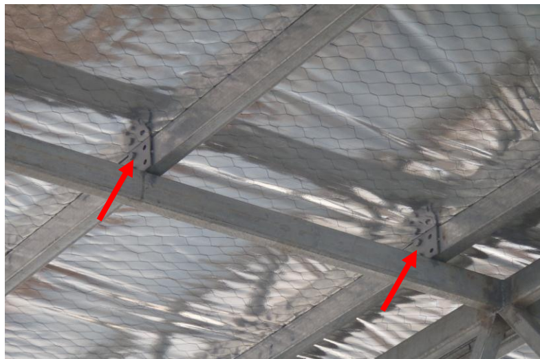
Gambar 2 : Pemasangan sambungan bolt pada kekuda bumbung tidak sempurna.
