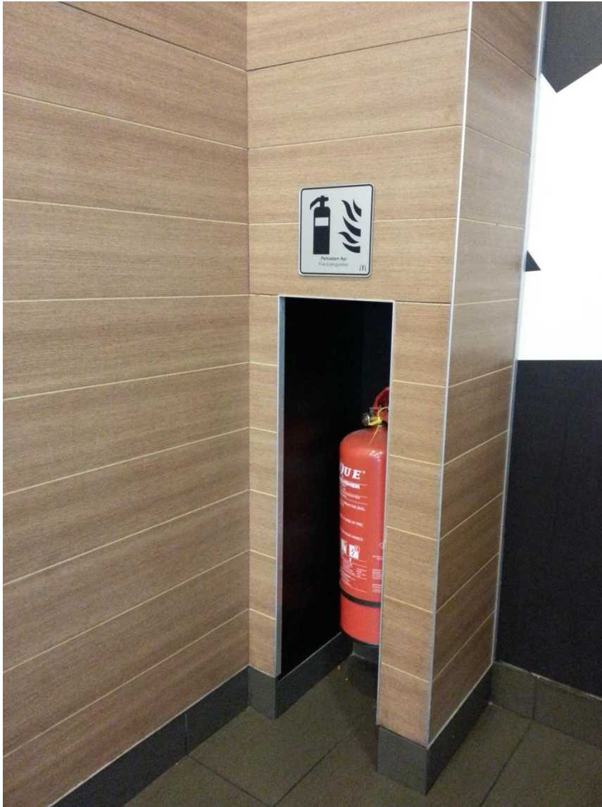
LOKASI FIRE EXTINGUISHER – LALUAN TANDAS
