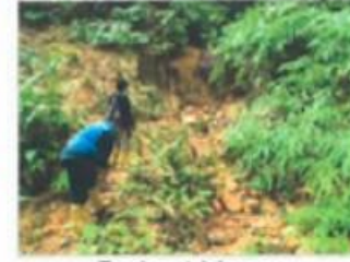
Photo E Tanah runtuh lampau
