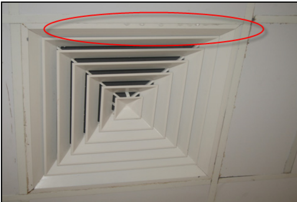
Gambar 14: Berlakunya kondensasi pada supply diffuser di bilik Pemerhatian.
