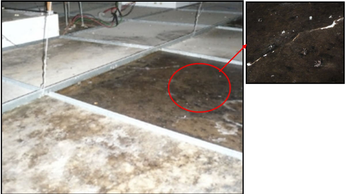
Gambar 7: Keadaan siling yang berkulat dan basah mengakibatkan kerosakan pada siling.
