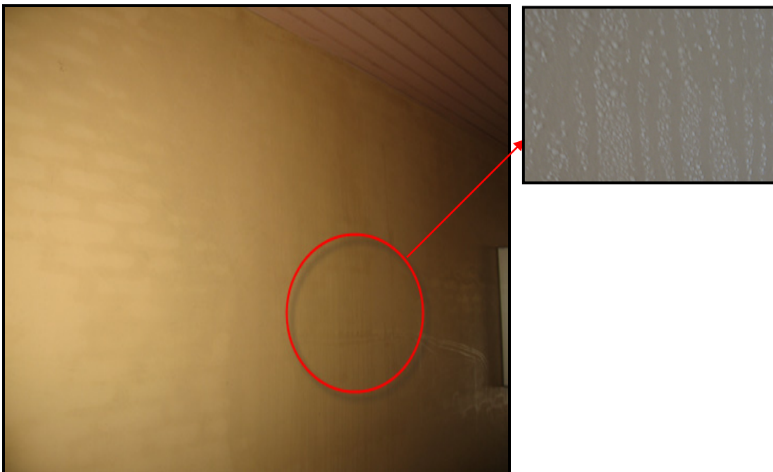
Gambar 12: Berlaku kondensasi pada permukaan dinding koridor.
