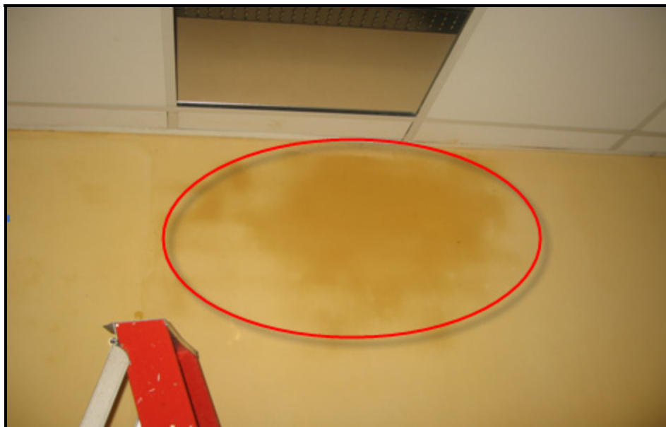
Gambar 10: Berlaku kondensasi pada permukaan dinding koridor disebabkan penyaman udara di Bilik Server berfungsi secara 24 jam.
