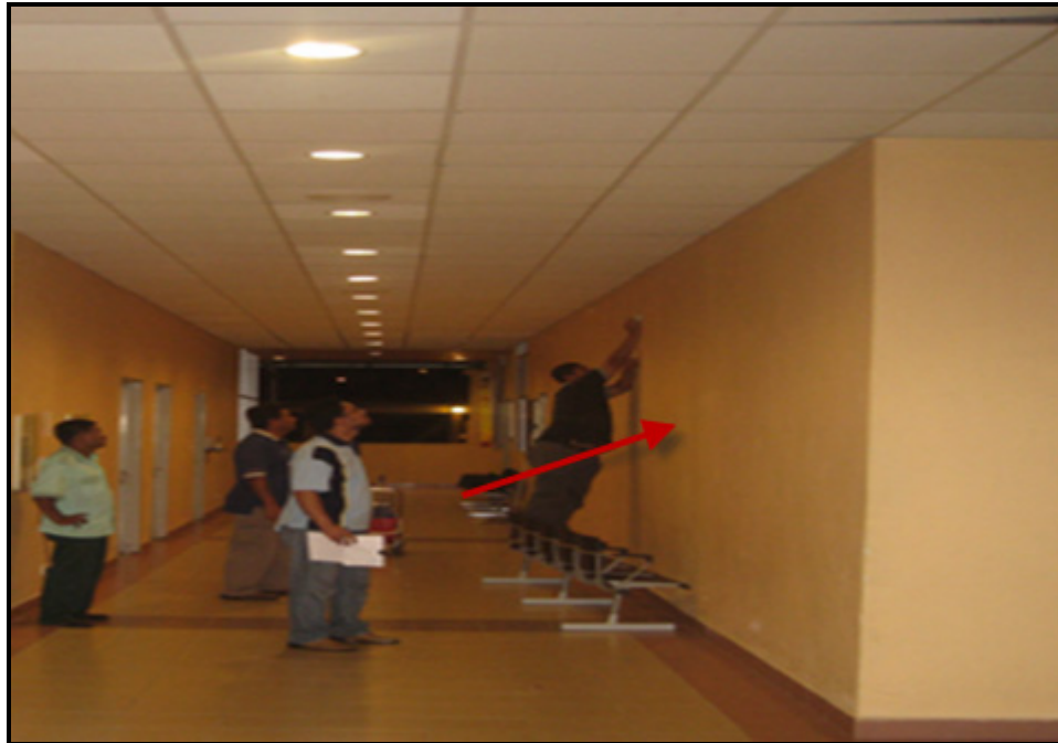
Gambar 13: Berlaku kondensasi pada permukaan dinding koridor.
