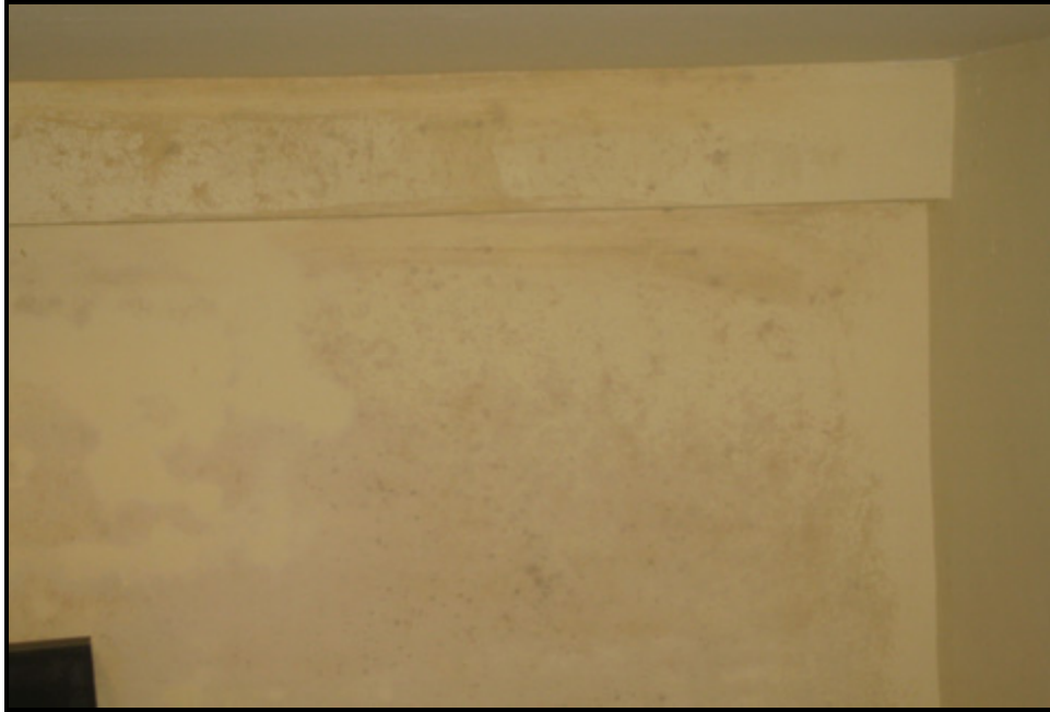
Gambar 11: Terbentuk kulat pada dinding tangga yang terletak bersebelahan dengan Bilik Server.
