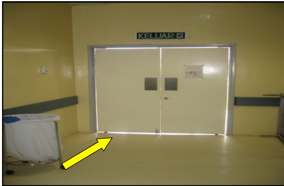
Gambar 5: Terdapat kebocoran udara luar (infiltration) melalui ruang antara pintu dan dinding.
