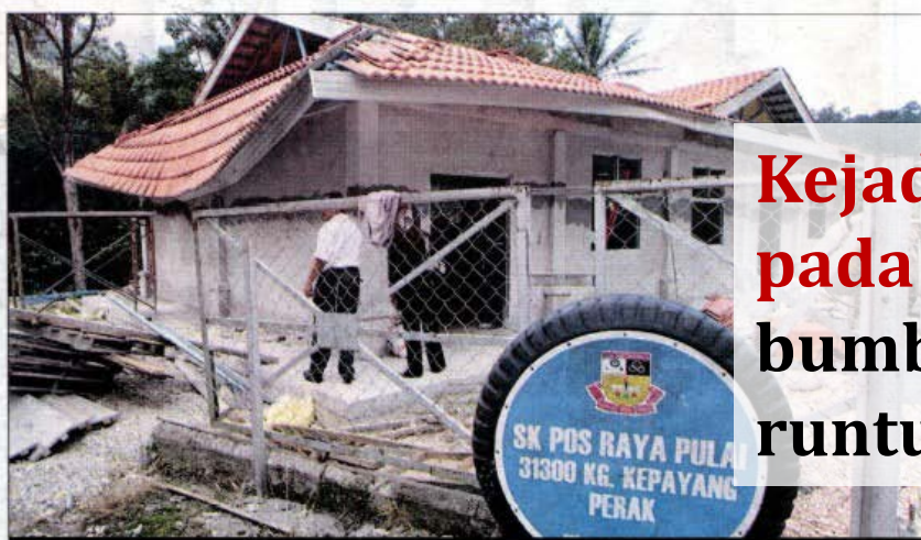
SEBAHAGIAN bumbung makmal komputer SK Pos Raya, Kampung Kepayang, Simpang Pulai yang runtuh semalam.
