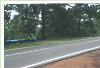
Rompin sebelum pembaikan.
