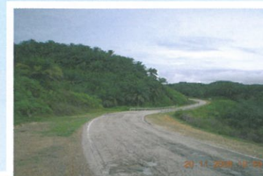
Permukaan jalan beralun.
