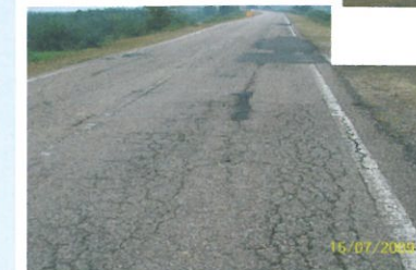
Permukaan jalan retak teruk.
