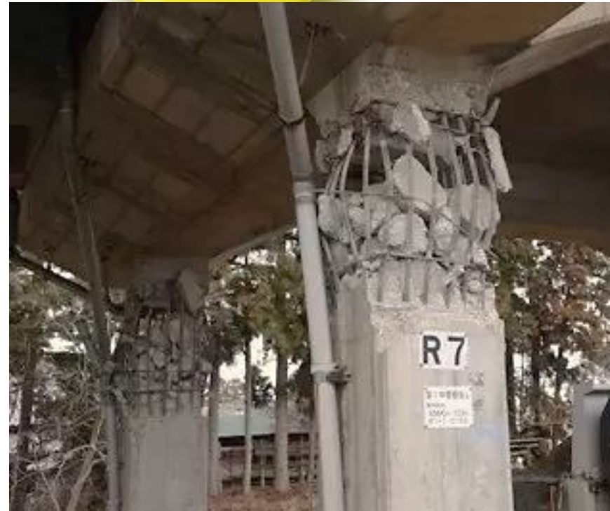
Retak “crushing and bulging” pada tiang
