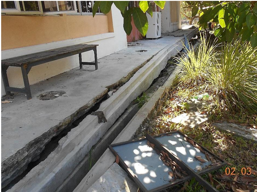
Retak pada apron disebabkan pemendapan tanah
