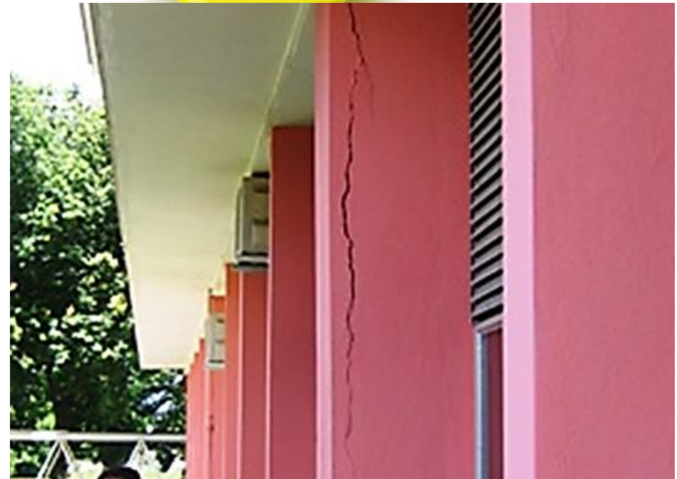
Retak menegak di sepanjang garisan tetulang menunjukkan berlaku pengaratan besi tetulang
