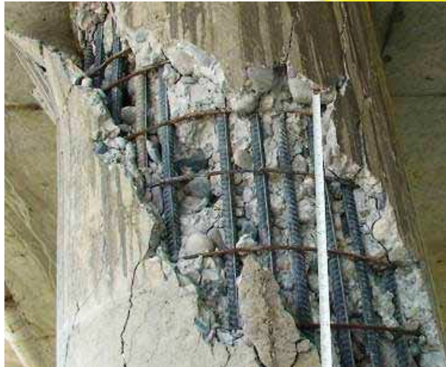
Retak diagonal yang berbentuk spiral pada tiang
