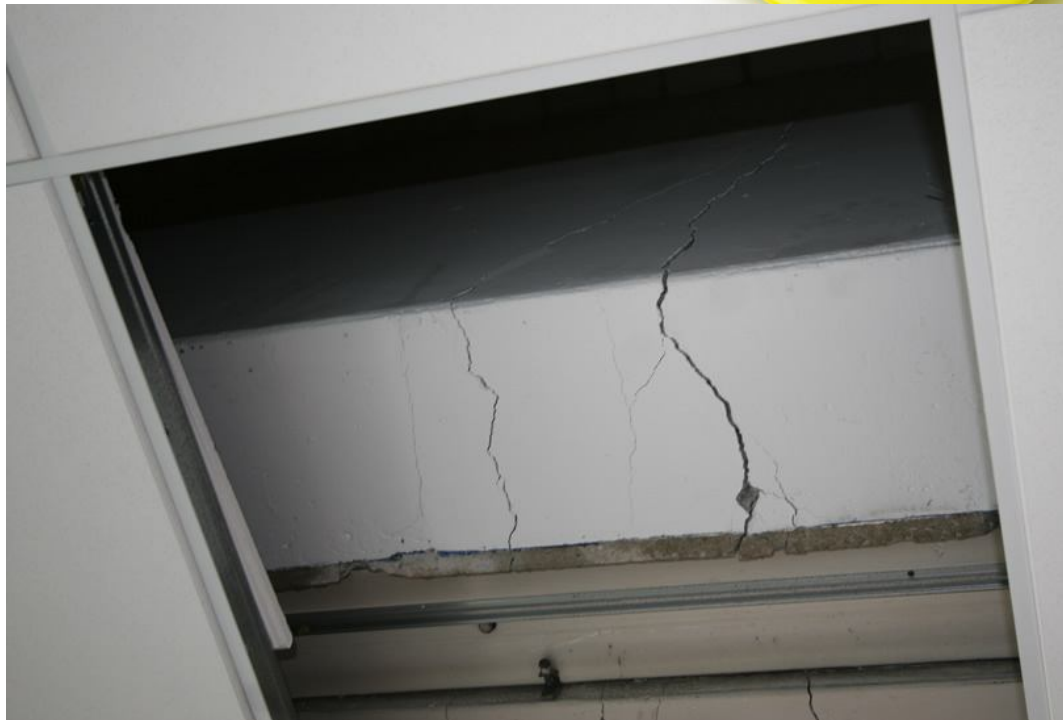
Retak menegak yang bermula dari soffit dan di tengah-tengah rasuk
