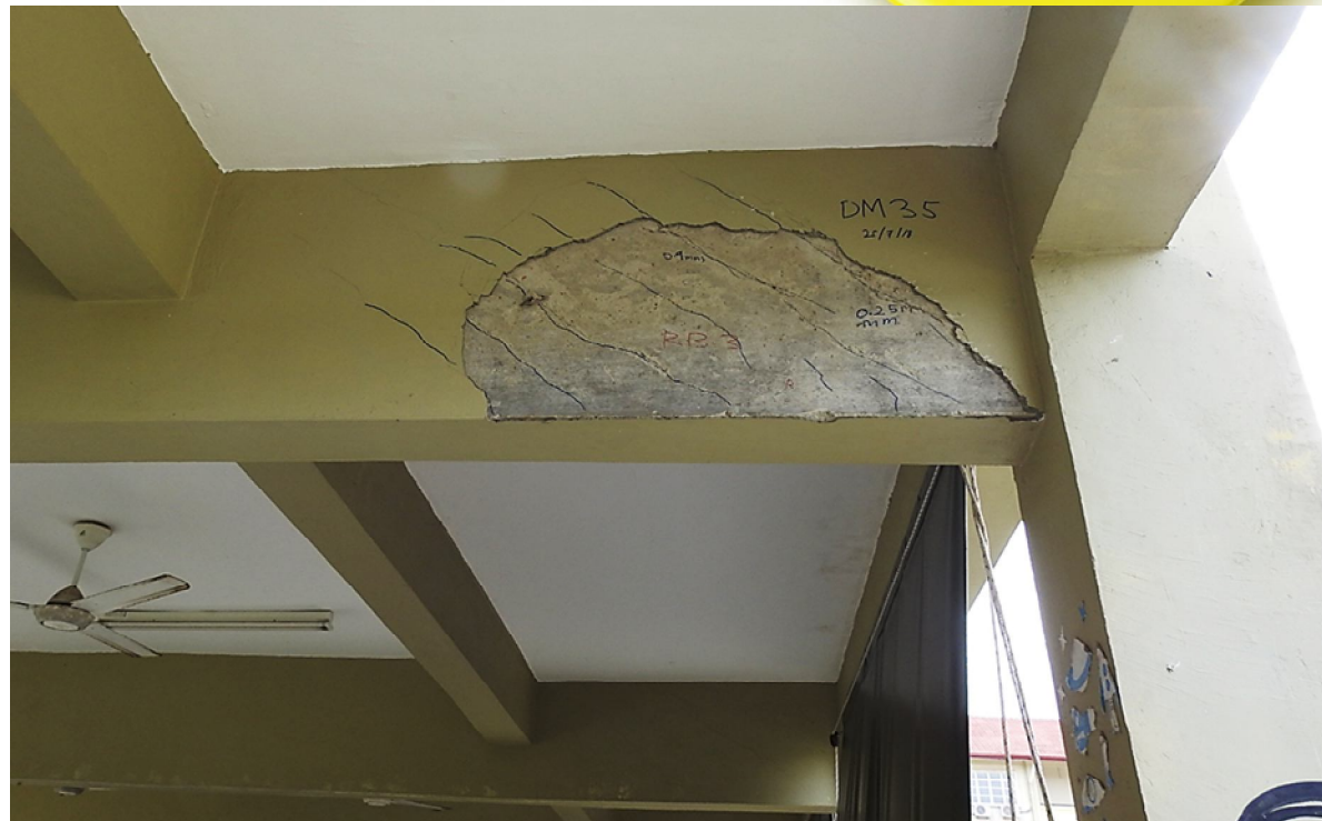
Retak diagonal yang berhampiran dengan penyokong
