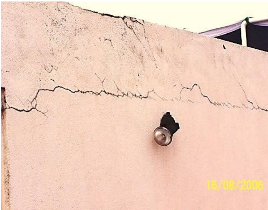
Retak pengecutan pada lepaan di sepanjang permukaan antara rasuk dan dinding bata
