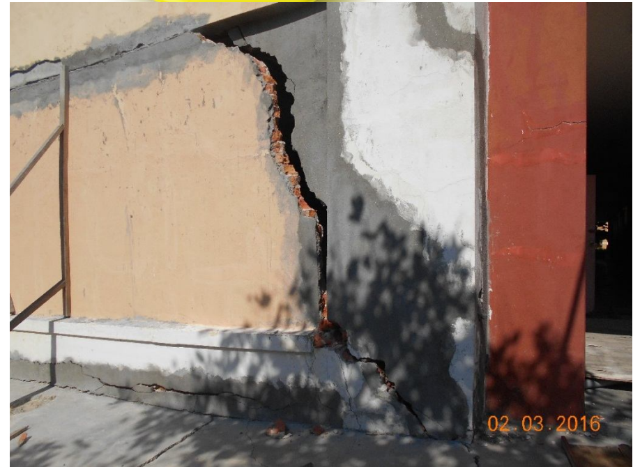
Retak pada dinding disebabkan pemendapan tidak sekata (differential settlement)
