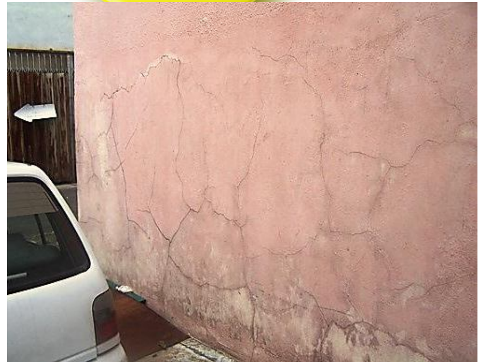
Retak pengecutan pada dinding akibat pengecutan bahan lepaan
