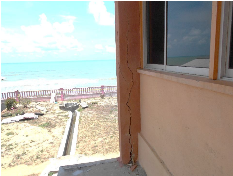
Retak menegak di sepanjang tiang bangunan yang terletak berhampiran dengan laut
