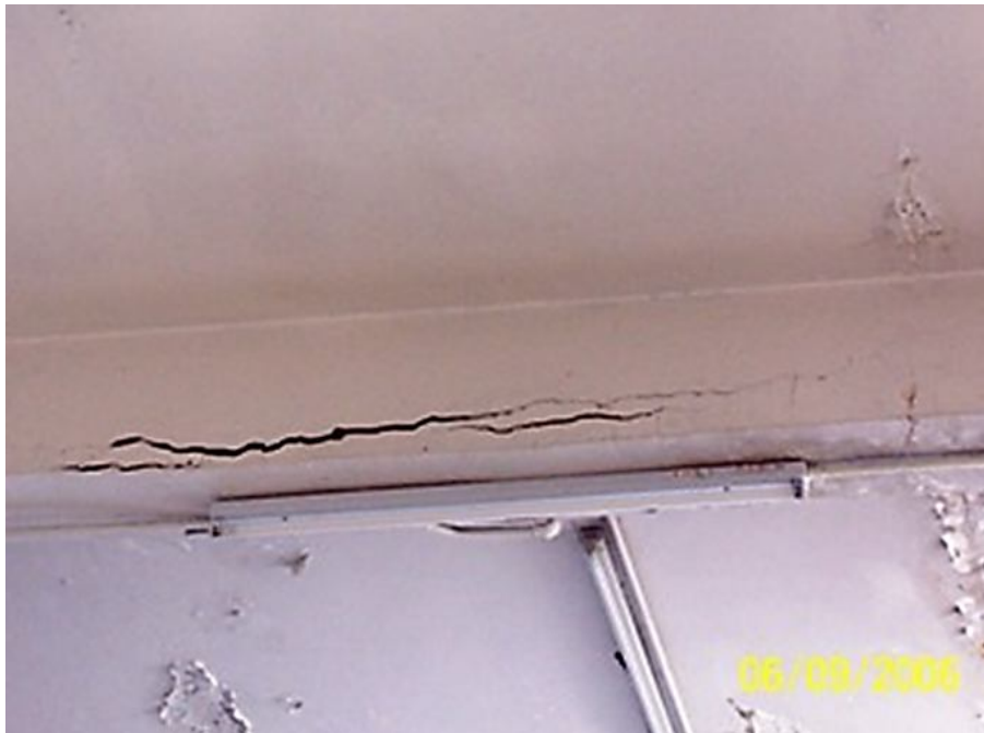
Retak berhampiran soffit rasuk disebabkan pengembangan besi tetulang yang berkarat
