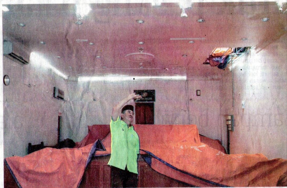
MOHD. Ali Rustam meninjau kerosakan siling Kompleks Mahkamah Majistret Jasin yang runtuh dipercayai akibat hujan lebat di Jasin, Melaka, semalam. - UTUSAN/GAIE UCHEL
