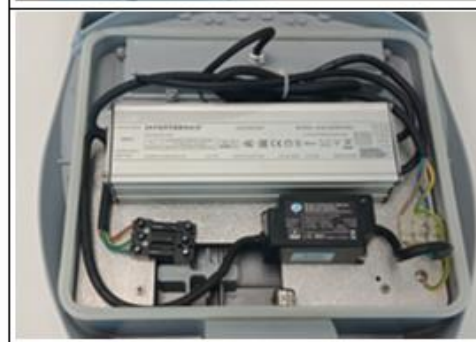
Gambar 5 Road Lighting (LED) - Pandangan Dalam
