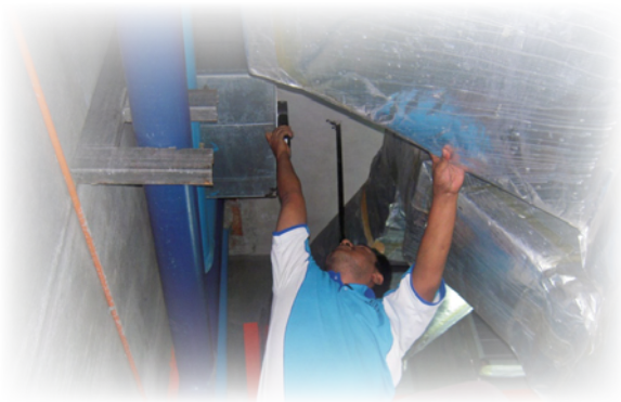
Mengambil bacaan air flow fresh air
