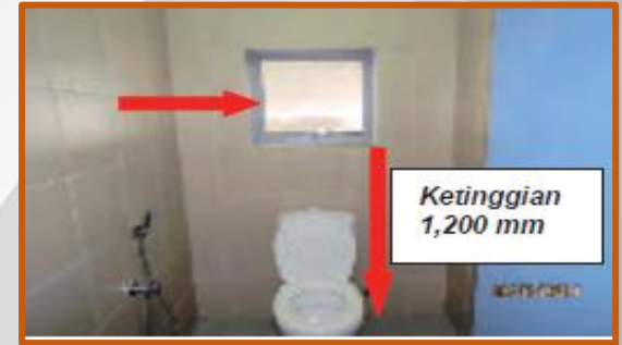
Ketinggian pemasangan tingkap yang tidak sesuai akan menjejaskan keselesaan kepada pengguna wanita di mana ketinggian antara lantai dengan tingkap adalah 1,200 mm.
