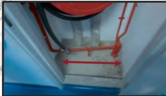
Floor Trap tidak disediakan pada setiap aras bagi bilik hose reel . Ini akan menyebabkan air bertakung apabila berlaku kebocoran.
