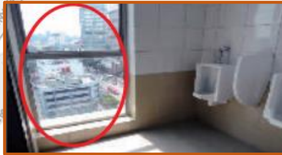
Tandas kaca yang dipasang tidak sesuai dan menyebabkan ketidakselesaan pengguna. Tingkap kaca ini dipasang di semua aras tandas
