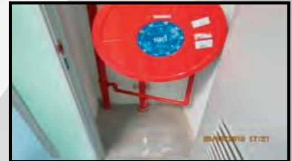
Air release valve untuk hose reel tidak disediakan
