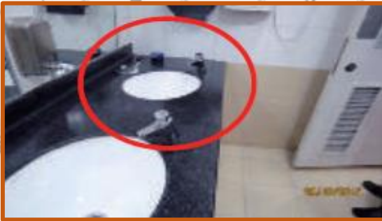
Kedudukan pili air yang tidak sesuai
