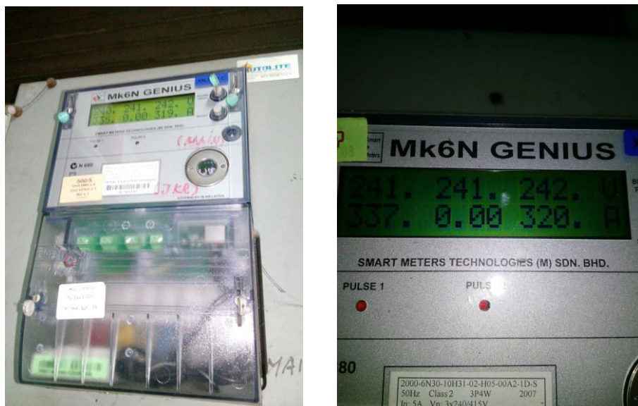
Gambar 8: Tiada Bacaan Pada Meter TNB Bagi Fasa Kuning
