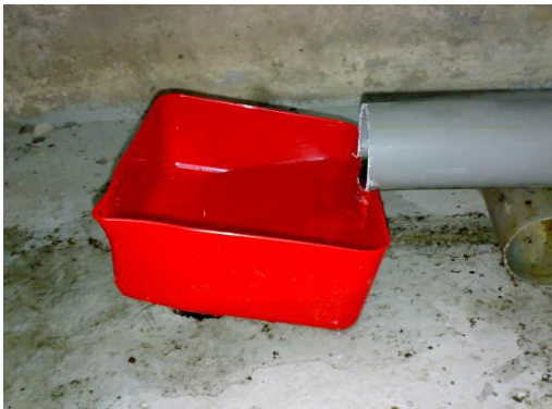
Air dikumpul dalam masa tertentu dari paip kondensasi yang terdapat di AHU
